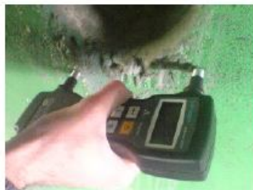
تعیین عمق ترک به وسیله دستگاه تستر اولتراسونیک
