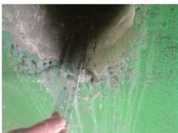
تعیین عمق ترک از طریق سونداژ
